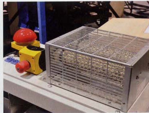
Détail de l'armoire de commande : ATU à clef + compartiment des résistances de freinage
